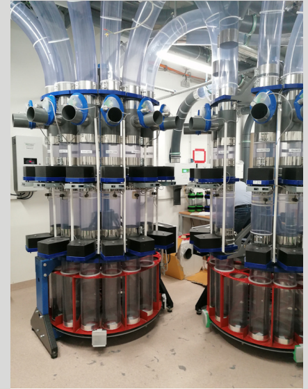
Das Bild zeigt zwei Revolver. Diese werden in der Regel im Technikraum des Gebäudes untergebracht.
