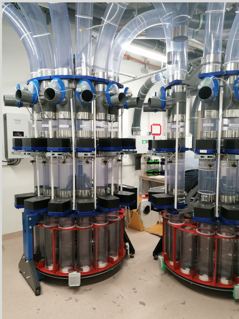
Das Foto zeigt unseren Revolver. Dieser wird in der Regel in einem Technikraum im Keller des Gebäudes untergebracht.
